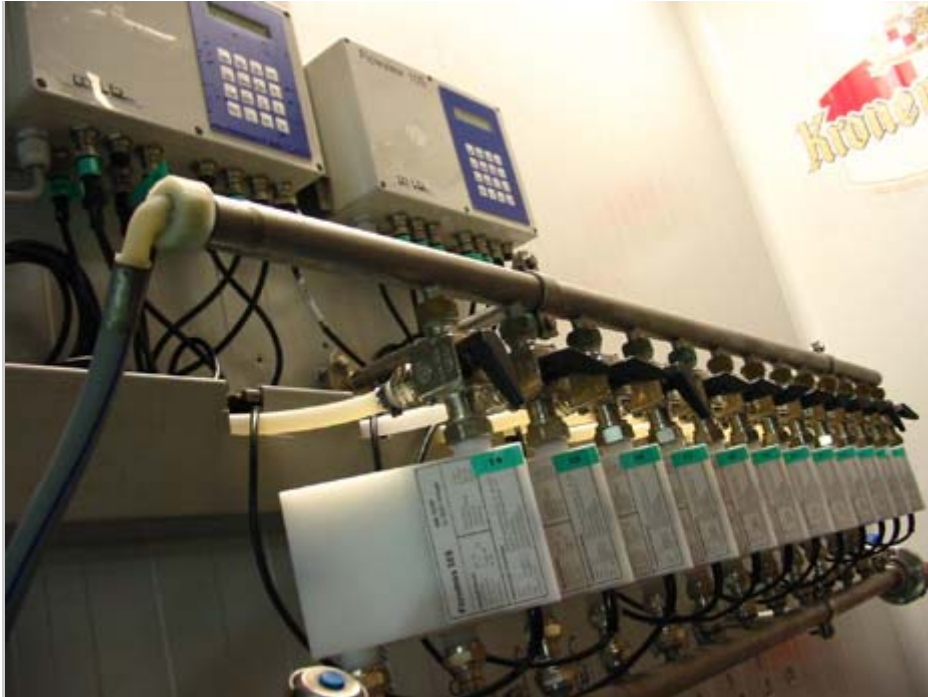
Tankkeller mit Bierverteiler und Messgerät Flowmax 30S. Bild: MIB GmbH Messtechnik & Industrieberatung
