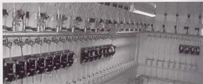
Kühlzelle mit Durchflussmessgeräten
